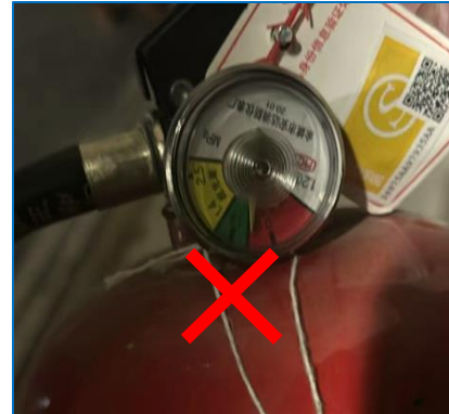
灭火器锈蚀、欠压、破损
