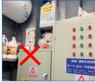
配电箱周边堆放可燃物
